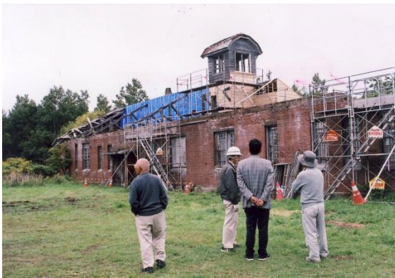
崩れ落ちた屋根、望楼の修復が続く赤レンガ通信所中棟
